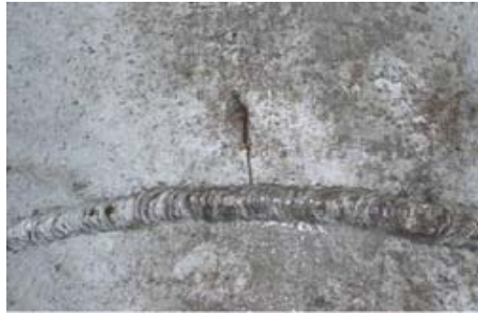
Рис. 4. Тріщина орієнтована поперек осі стикового кільцевого шва
